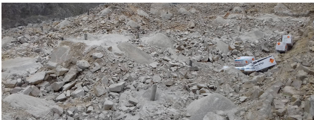
Figura 105. Distribuição dos explosivos a cada furo na perspectiva SW da pedreira, nessa imagem demonstra os furos com encaixo de tubo PVC, evitando o desmoronamento de detritos no furo.
