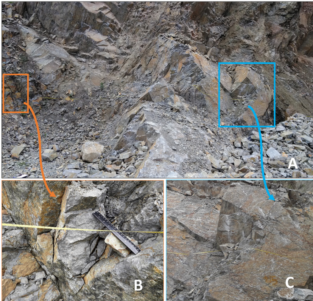
Figura 94. Aspeto de alteração e fracturação do maciço rochoso da Pedreira de Jonize. A) Perspetiva SSE da bancada; B) Peridotito com minerais de olivina, hornblenda, piroxena e plagioclase; cor de amarelo avermelhado, efeito de oxidação de minerais Fe e Mg acentuado; C) Sistema de compartimentação do maciço de alteração (W2).
