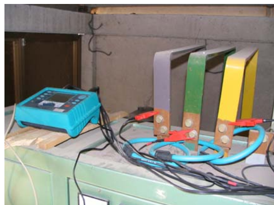
Sl. 2. Merenje potrošnje električne energije u transformatorskoj stanici
