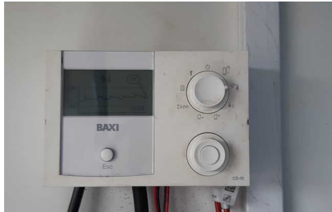
Figura 2.8 - Controlador do subsistema solar
