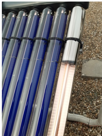
Figura 2.4 - Parte do conjunto dos coletores solares
