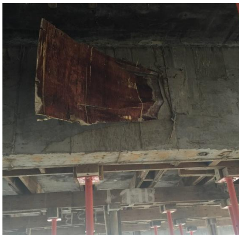
Figura 42 – Diluição Inadequada do Desmoldante
