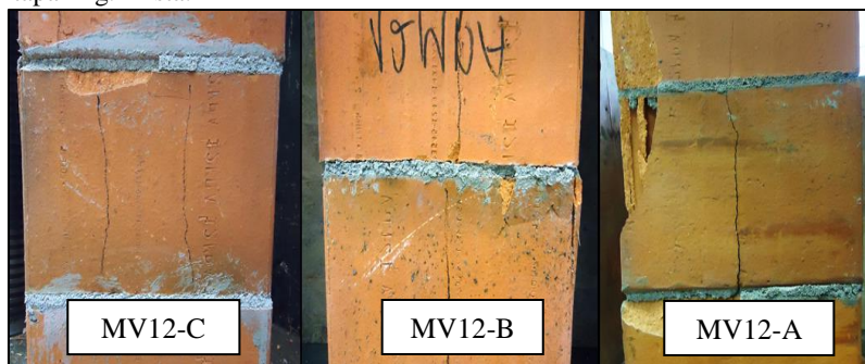
Figura 4.26 – Ruptura característica dos prismas vazios com os blocos B12 – Etapa Arg. Mista.
