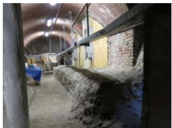
Fig. 4. Incongrua installazione di impianti su un tratto di muratura del complesso del Palazzo Imperiale.
