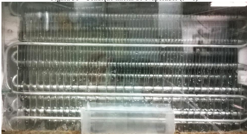
Figura 31 - Condição inicial do evaporador ( t = 0 )
