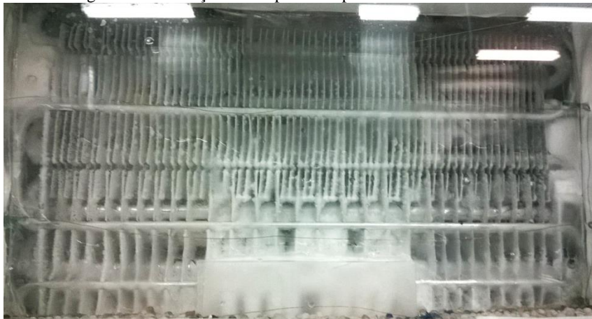
Figura 34 - Condição do evaporador após 4 h de funcionamento
