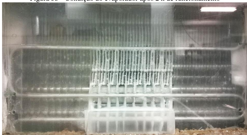
Figura 33 - Condição do evaporador após 2 h de funcionamento
