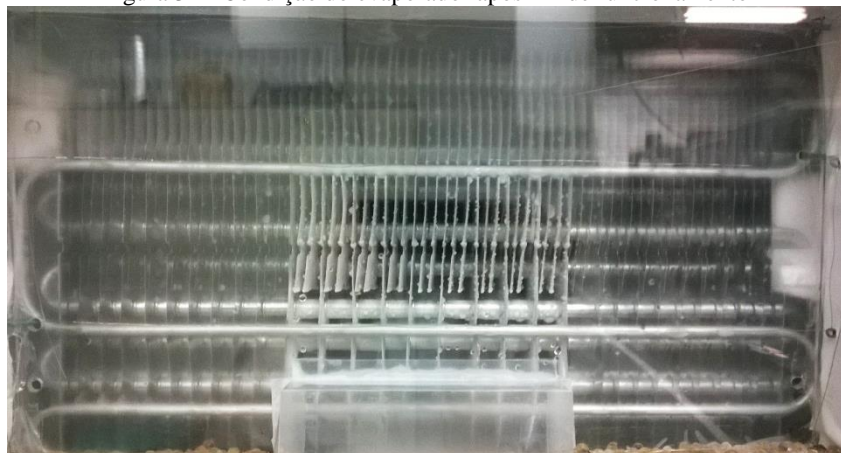
Figura 32 - Condição do evaporador após 1 h de funcionamento
