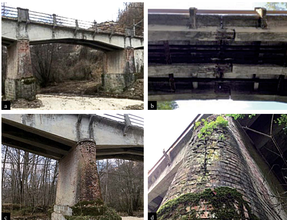
Figura 18 Ponte Rosa: (a) vista generale del ponte; (b) particolare sella Gerber; (c) appoggio delle travate in corrispondenza di una pila in muratura; (d) stato manutentivo delle pile in muratura.
