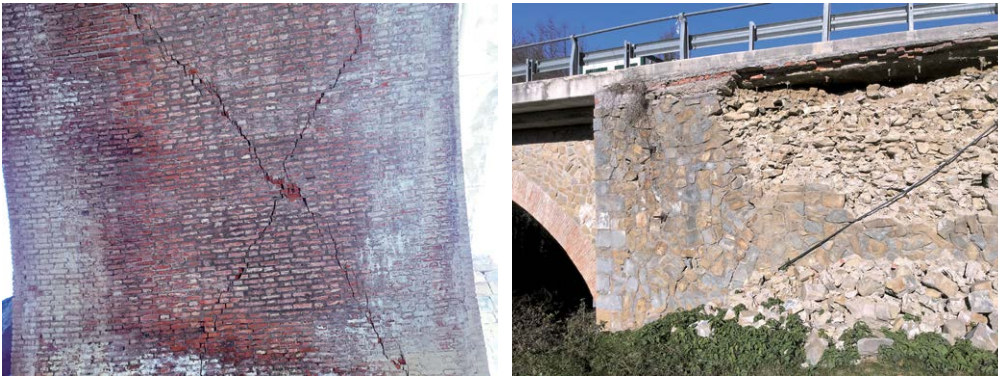
Figura 6 Lesioni diagonali all'intradosso dell'arco e muro d'ala posti in prossimità della spalla Est.
