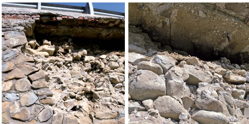
Figura 5 Collegamento inadeguato tra gli strati funzionali della carreggiata ed il muro d'ala.
