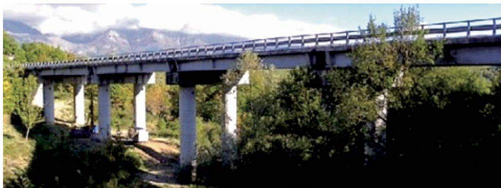
Figura 14 Viadotto "Scandarello" lungo la SS4 in prossimità di Amatrice, coordinate 42.643309 N, 13.266802 E (adattato da ANAS, Relazione Esecutiva, 2010).
