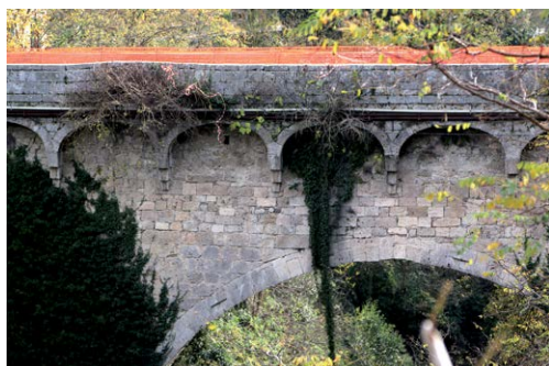
Figura 10 Ponte di Mozzano: vista laterale: vista frontale ed interna del danneggiamento del parapetto murario.
