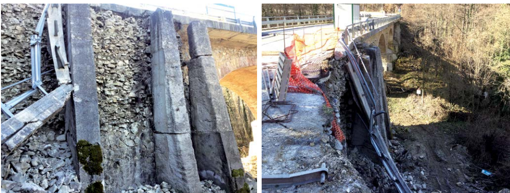
Figura 7 Collassi lungo il muro d'ala posto a Nord, in prossimità della spalla Est.
