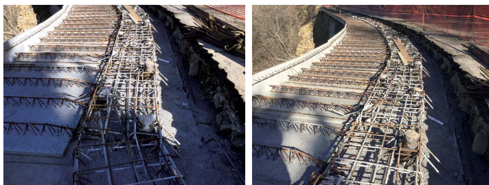
Figura 6 Interventi di somma urgenza per la messa in sicurezza per il Ponte Tre Occhi.
