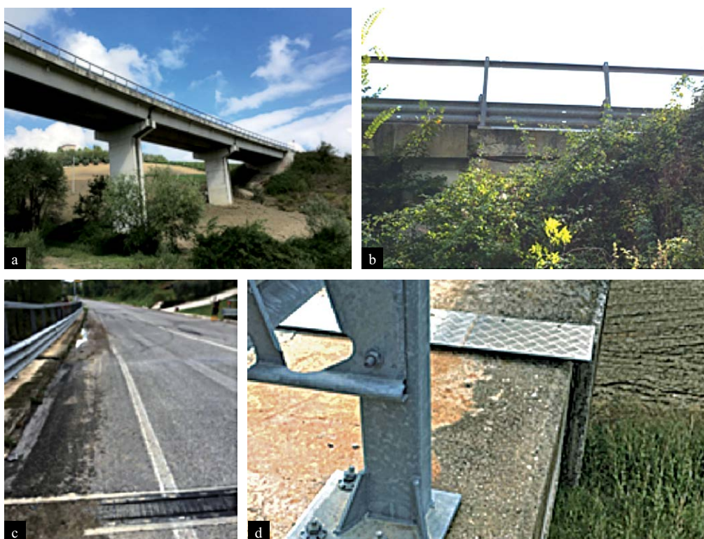
Figura 17 Viadotto in c.a. lungo la SP173, coordinate 42.941687 N, 13.702294 E: (a) vista generale del ponte; (b) abbassamento della sede viaria in corrispondenza di una spalla; (c) lesioni del manto della pavimentazione in corrispondenza di una spalla; (d) spostamenti relativi della spalla.
