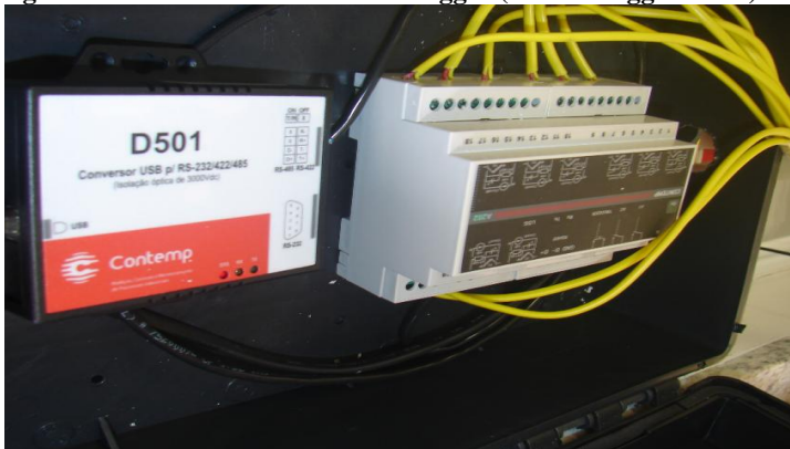
Figura 49 - Conversor D501 e Datalogger (MasterLogger A202)
