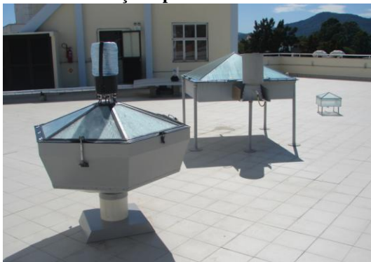
Figura 27 - Pilotos 01, 02 e 03 Potabilizadores Solares – Terraço Departamento ENS/UFSC
