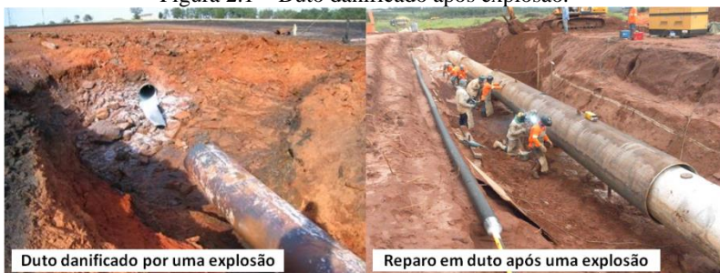
Figura 2.1 – Duto danificado após explosão.
