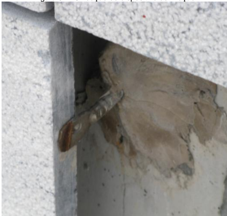
Figura 34 - Oxidação do dispositivo de fixação.
