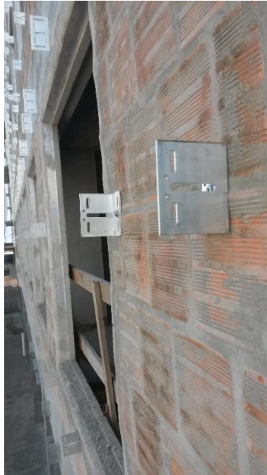
Figura 27 - Cantoneiras metálicas do sistema de fixação.
