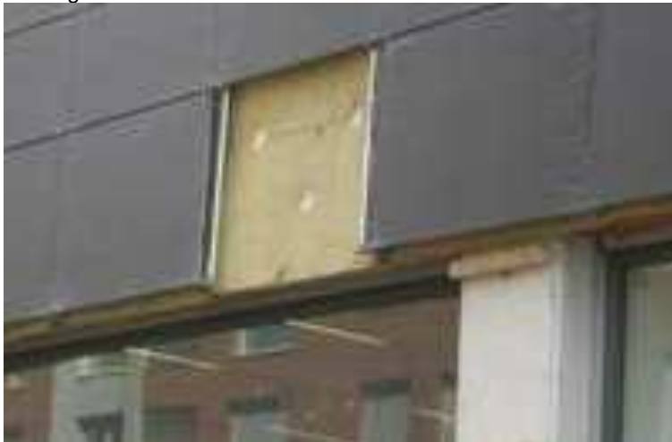
Figura 36 - Queda de revestimento da fachada ventilada.
