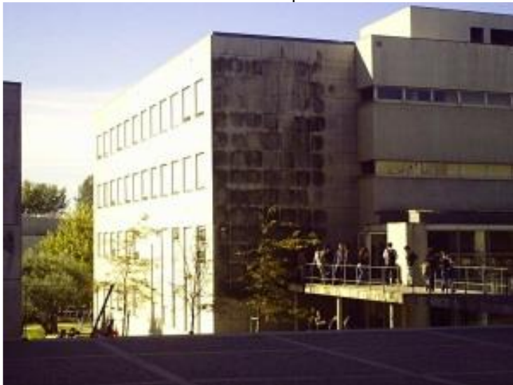
Figura 37 - Manchas de microrganismos em fachada ventilada com revestimento de pedra natural.
