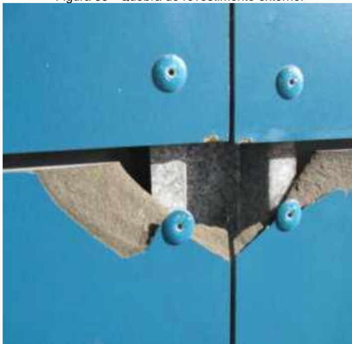
Figura 35 - Quebra do revestimento externo.
