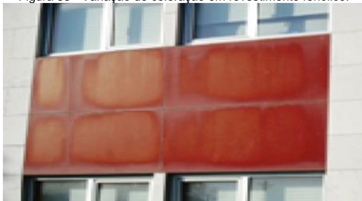
Figura 33 - Variação de coloração em revestimento fenólico.
