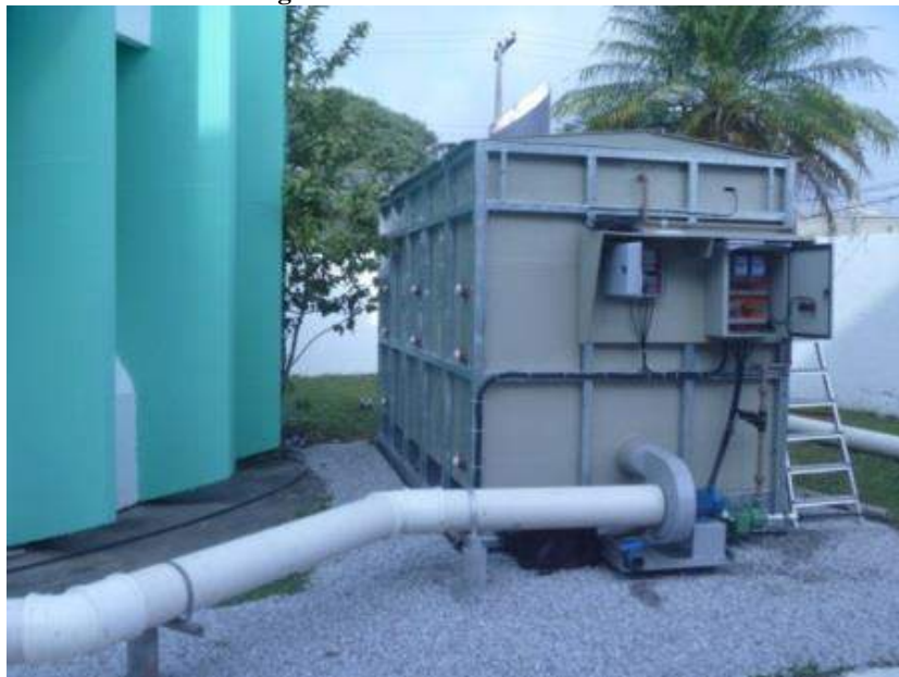
Figura 3 - Vista frontal do biofiltro
