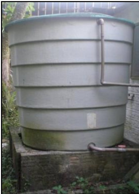
Figura 5 - Reservatório de fibra de vidro utilizado para armazenamento do lixiviado bruto.
