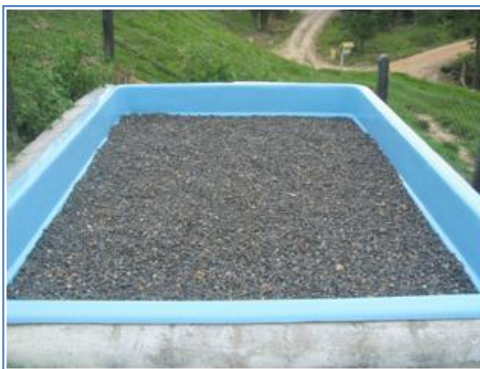
Figura 7: Filtro de pedras para polimento de dejetos suínos
