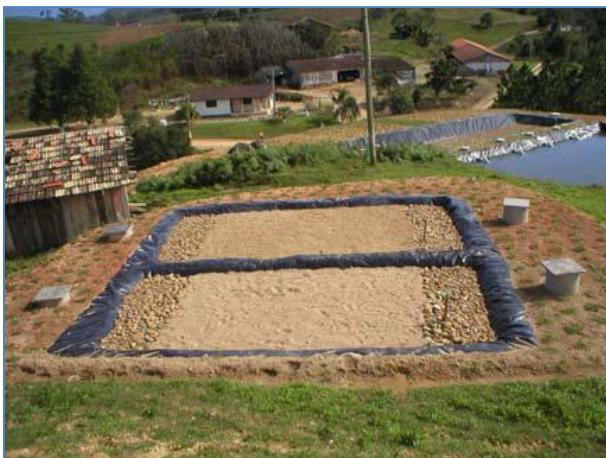
Figura 4: Filtros de areia (escala reduzida)
