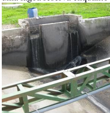
Figura 8- Caixa de Retenção
