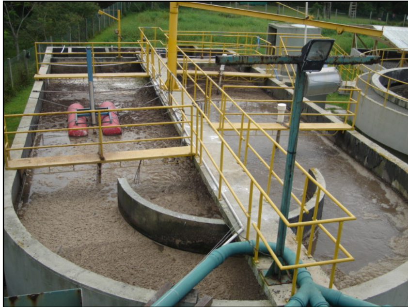
Figura 2 – Tanque de Aeração (TAE).
