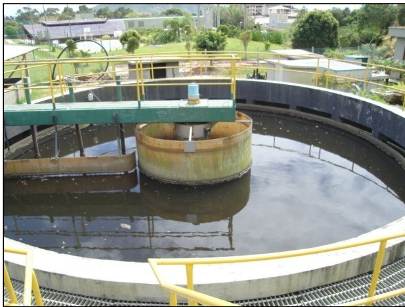
Figura 3 – Decantador Secundário (DCS).
