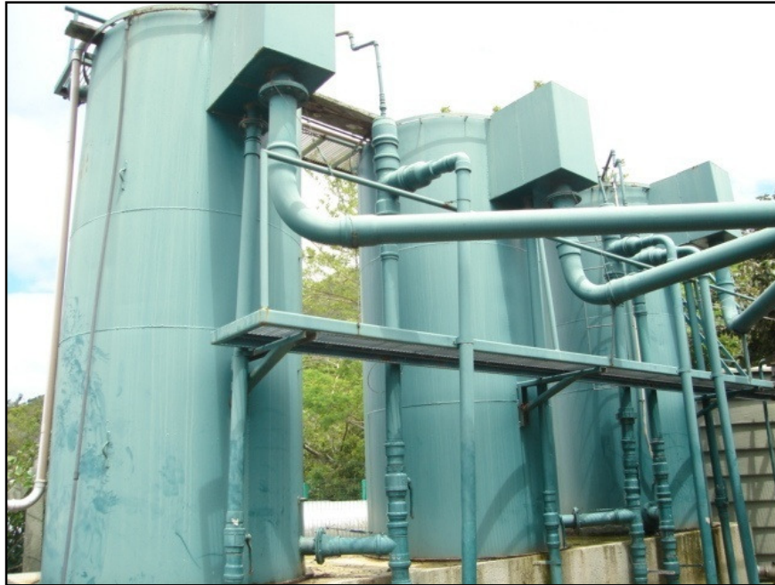
Figura 4 – Filtros de Gravidade.
