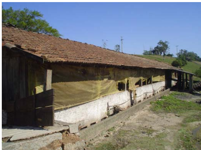
Figura 22 – Foto que mostra que os telhados das baias não possuem estrutura para o aproveitamento da água pluvial. Fonte: Vamblê, outubro de 2007.
