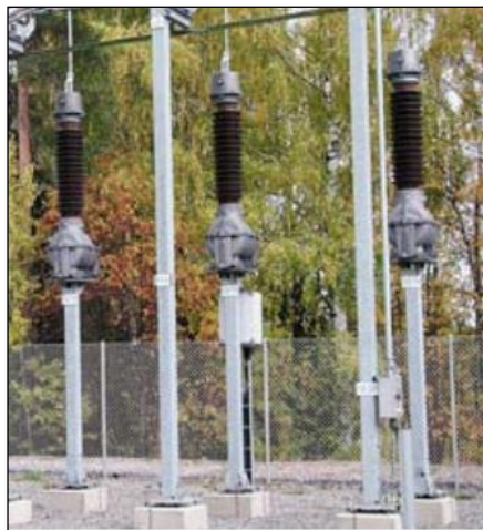
Figura 3.2 - Transformador de potencial indutivo. Fonte: (ABB, 2009)
