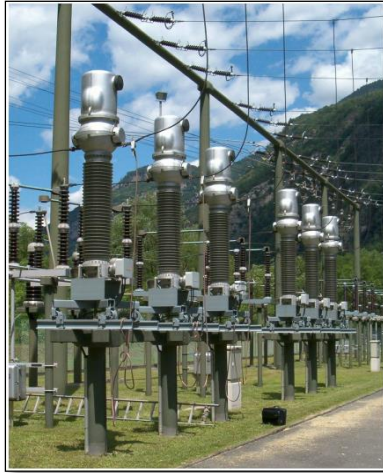
Figura 3.7 - Transformadores de corrente. Fonte: Trench Group, 2009.
