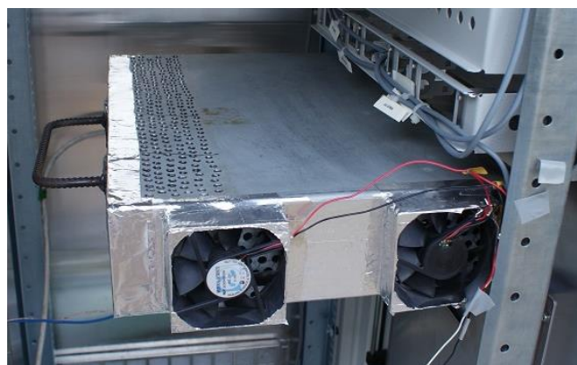
Figura 4.10 - Ventiladores presentes na caixa onde se encontra a resistência
