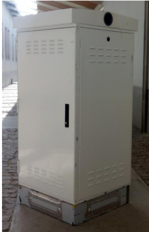
Figura 4.5 - Vista exterior do armário em estudo
