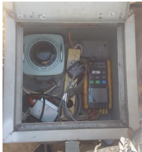
Figura 4.24 - Caixa metálica que abriga alguns dos equipamentos auxiliares.
