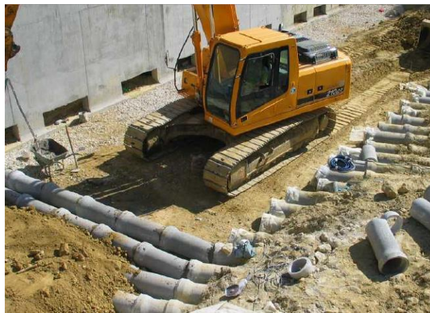
Figura 3.11 - Pormenor da instalação das tubagens (Adaptado de INETI, 2005).
