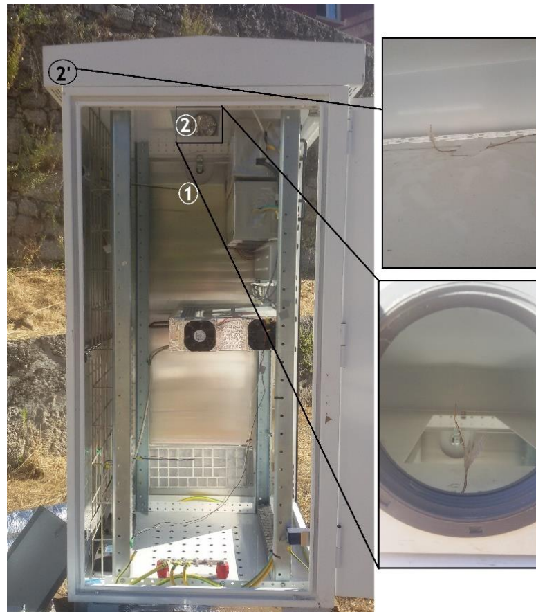
Figura 4.22 - Esquerda: Localização dos termopares presentes no interior do armário; Direita: Pormenor das localizações do termopar 3.
