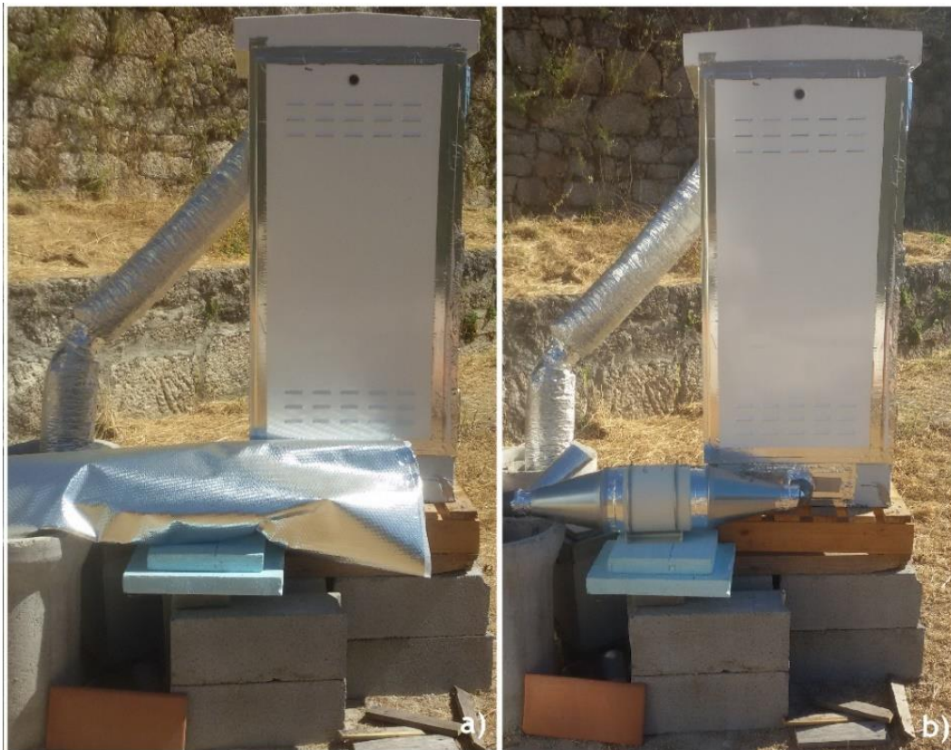
Figura 4.12 - Ventilador e respetivos acessórios instalados. a) ventilador e tubo de retorno com isolamento térmico; b) ventilador sem isolamento térmico e tubo de retorno com isolamento térmico.
