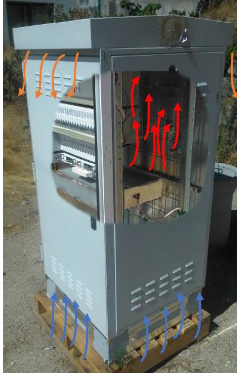
Figura 4.30 - Esquema do fluxo de ar no sistema de arrefecimento original do armário (Adaptado de Diogo, 2017).
