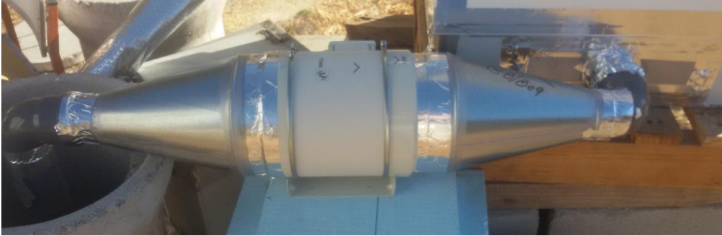
Figura 4.25 - Vedações realizadas na ligação entre a saída de ar do permutador de calor ar-solo (esquerda) e a entrada de ar no armário (direita).
