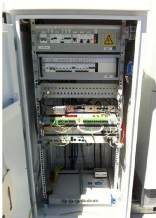
Figura 4.2 - Armário ABE_V2, equipado com os equipamentos referidos e em pleno funcionamento (Delgado, 2016).
