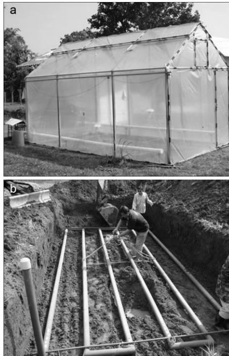
Figura 3.7 - Vista exterior da estufa e implementação do permutador de calor ar solo (Mongkon et al., 2013).
