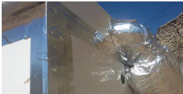
Figura 4.26 - Ligação entre a saída de ar do armário e o tubo de retorno para o permutador.
