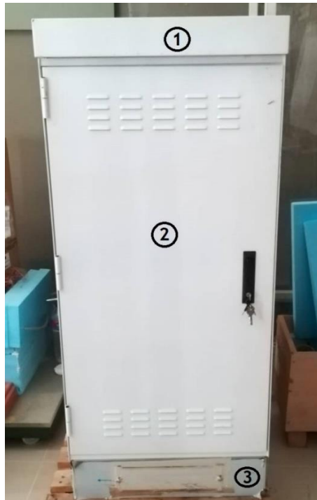
Figura 4.1 - Armário de telecomunicações ABE_V2. 1) Cobertura do armário; 2) Armário de telecomunicações; 3) Pedestal (chão falso).
