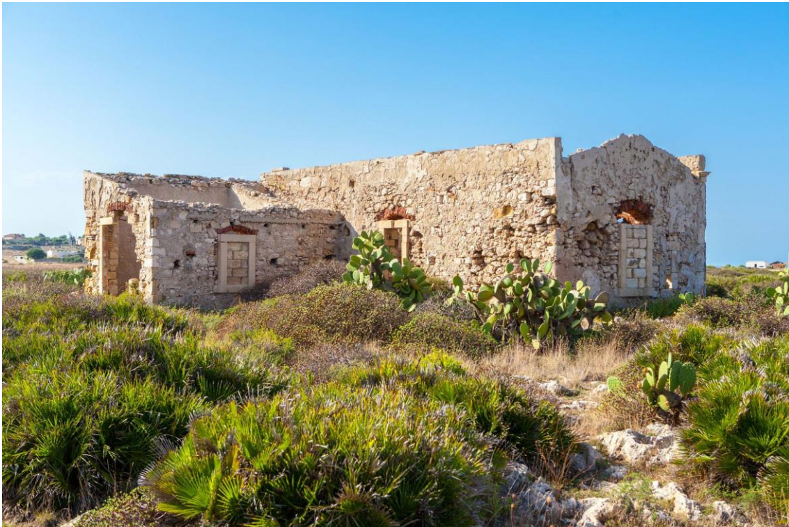
Figura 21. Estado de degradação dos Edifícios adjacentes ao Farol Murro di Porco.
