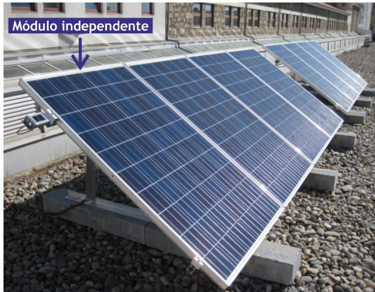
Figura A.1 - Módulos PV instalados na faculdade de engenharias da UBI.
