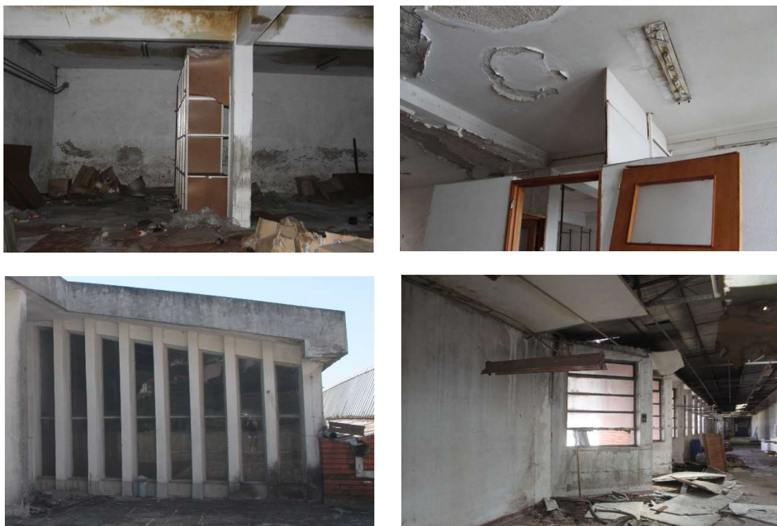
Figura 36 - Imagens das patologias existentes
