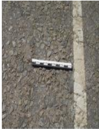
Figura 2.9- Desagregação superficial (Tavares, M., 2013)
