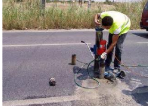
Figura 3.1- Execução de sondagens à rotação (Antunes, M. et al., 2005 citado por Santos, M., 2009)
