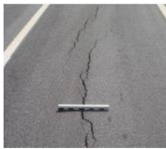
Figura 2.7- Fenda longitudinal (Tavares, M., 2013)
