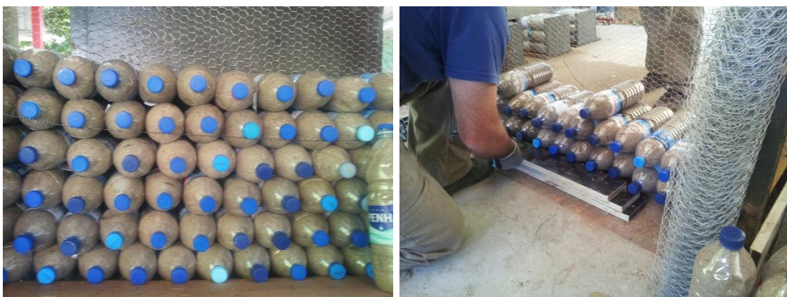
Figura 4.7. Curvatura e instabilidade, necessita de um suporte
