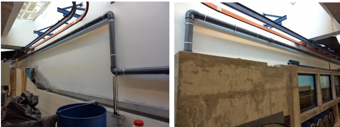
Figura A4. 2: Circuito de recirculação. Conduitas de PVC ( \varnothing 200 mm).
