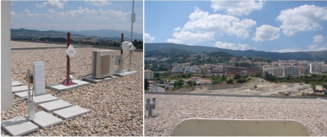
Figura 9.11 – Local da instalação da estação base na segunda fase de teste.
