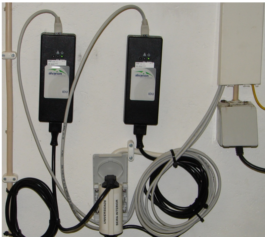
Figura 7.16 – Instalação na estação repetidora da Serra da Gardunha.
