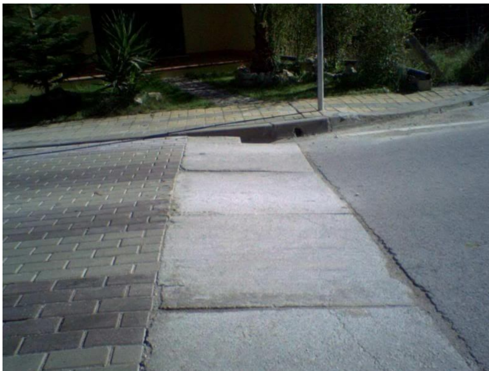
Figura 20 - Exemplo de um efeito “Portão” no início de uma plataforma sobrelevada [Mealhada, 2005]
