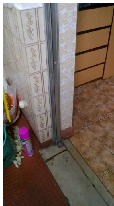
Figura 69 - Soleira de porta em pedra mármore e revestimento de pavimento com cerâmico pitonado (marquise) e ladrilhos cerâmicos (cozinha).
