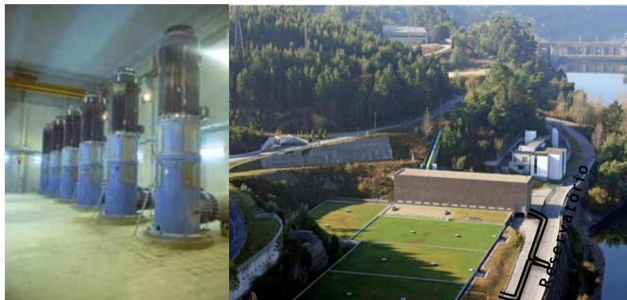
Figura 13- Elevação e Armazenamento de água tratada. a) Bombas elevatórias; b) Reservatório subterrâneo de água tratada.
