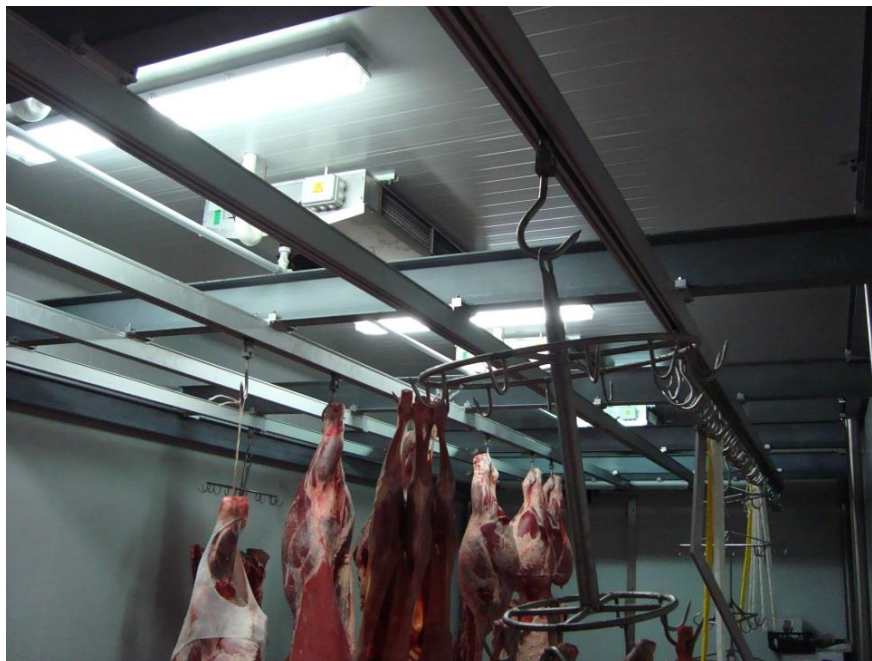
Figura 5- Vista da via aérea da câmara ensaiada (Viegas & Lucito) .
