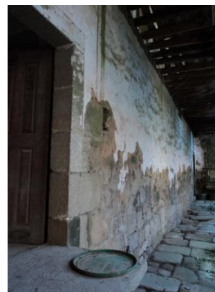
Figura 86. Parede da Igreja em Reboco pintado. Pavimento em terra.
