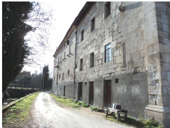
Figura 77. Vista Sul do conjunto monacal. Veja-se o emparelhamento da pedra remonta a épocas diferentes de construção.
