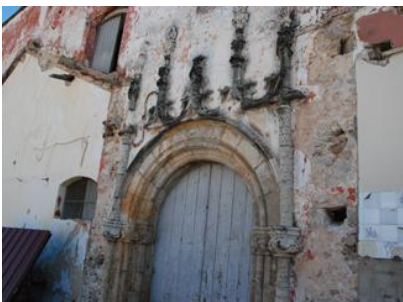
Figura 110. Mosteiro de Nossa Senhora da Conceição de Tavira. Portal Gótico Manuelino antes da reabilitação.
