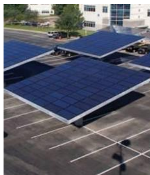
Figura 29_ Painéis Fotovoltáicos colocado num estacionamento ( www.metalgalva.pt )
