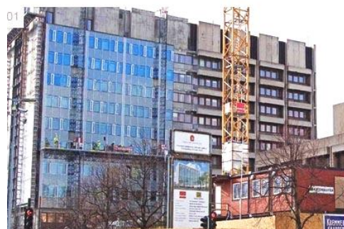
Figura 39 – Reabilitação da fachada de um edifício – Town Hall em Alesund – construído em 1979. A fachada dupla é formada por chapas de alumínio, vidro e granito, permitindo um melhor aproveitamento energético. (en.veidekke.com/news-and-media/news/article68849.ece, consultado em Abril de 2011)
