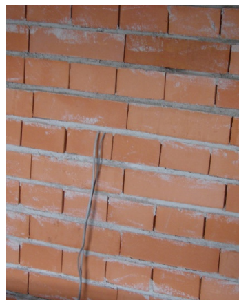
Figura 4.7 - Colocação do sensor de temperatura a meia espessura da parede acumuladora.
