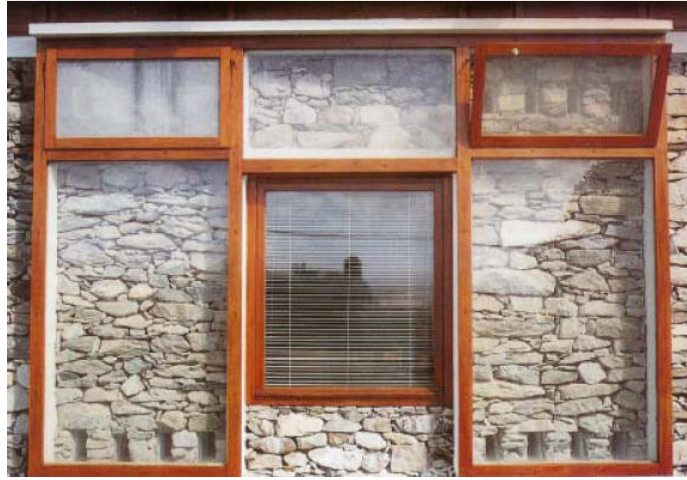
Figura 2.21 - Espessura de caixa-de-ar reduzida na casa Shafer em Porto Santo [58].
