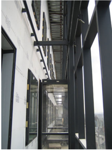
Figura 2.20 - Elevada espessura da caixa-de-ar numa parede de Trombe ( OHSU Center for Health and Healing ) [57].
