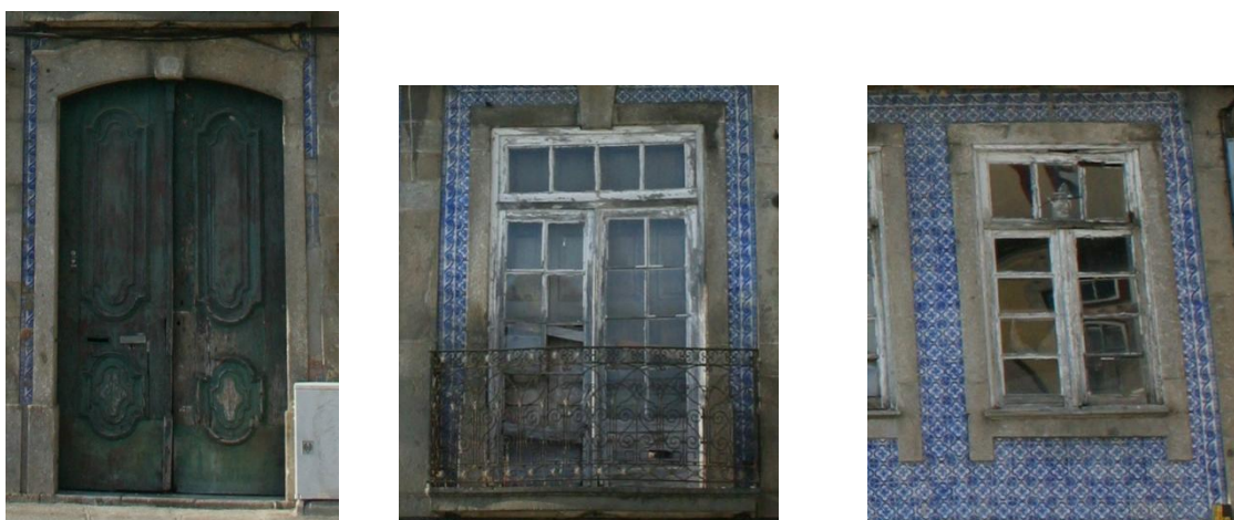
Figura 35: Vãos degradados do Edifício em estudo para Reabilitação
