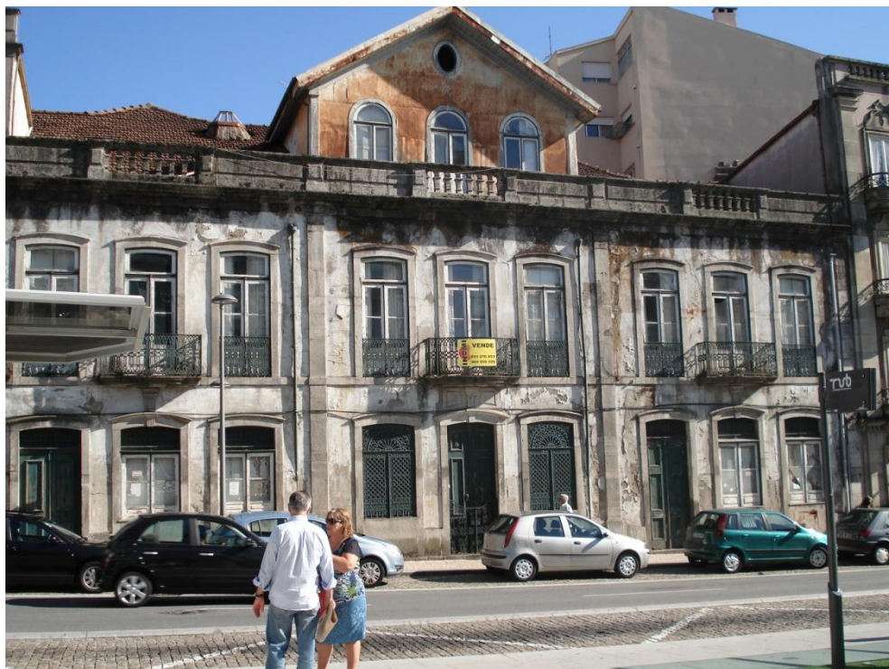
Figura17:Edifícios degradados e abandonados na rua perpendicular a Avenida da Liberdade
