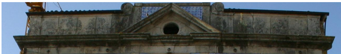
Figura 36: Parte superior degradada do Edifício em estudo para Reabilitação
