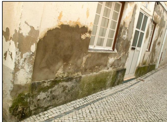
Figura 3 - Humidade do Terreno - http://filomenopequicho.blogspot.pt/2011/06/patologias-em-paredes-exteriores-de.html
