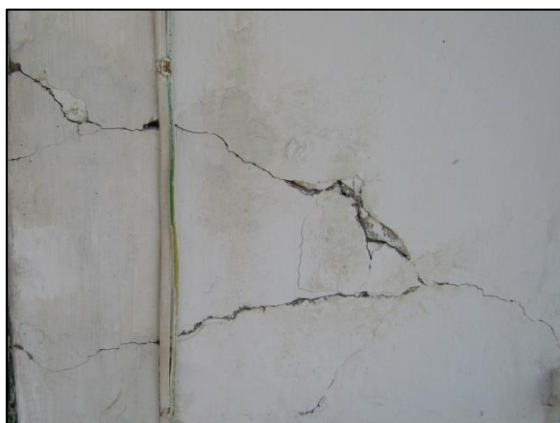
Figura 41 - Fissura na Fachada
