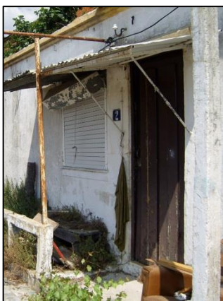
Figura 43 - Porta e Janela Deteriora
