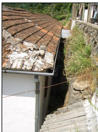
Figura 44 - Telhado em Mau Estado de Conservação
