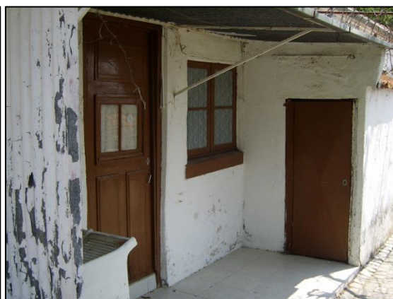
Figura 42 - Pintura em Mau estado de Conservação
