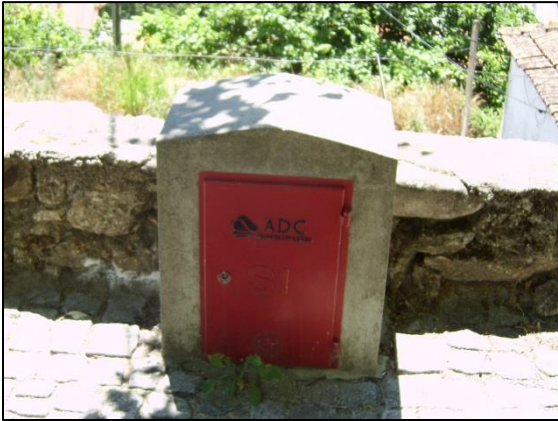
Figura 61 - Boca de incêndio
