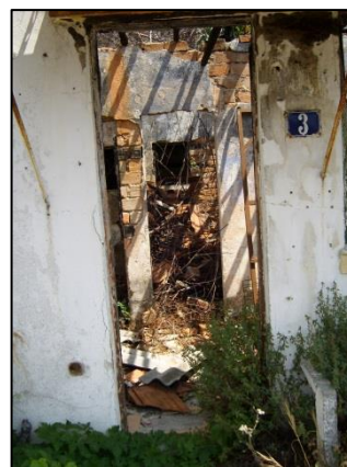
Figura 45 - Habitação em Ruínas
