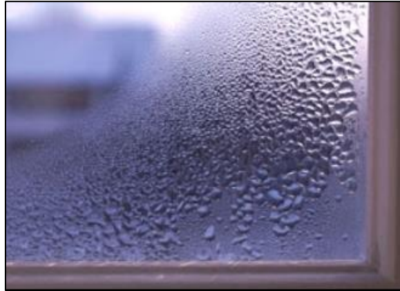
Figura 4 - Humidade Acumulada em Janela em Contato com o Exterior - http://valorizacaoimobiliaria.blogspot.pt/2010/12/humidade-ou-condensacao.html
