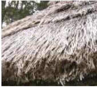
Fig. 29 – Palha arrancada do solo e colocada na cobertura com as raízes em direcção ao chão.
