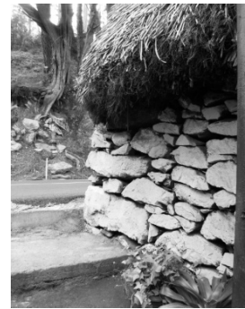
Fig. 4 – Caição das paredes de pedra.
