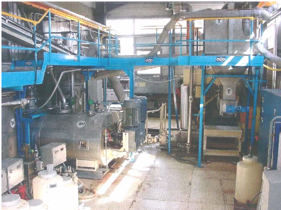
Figura II.12 - Espaço físico da instalação piloto do CTP.
