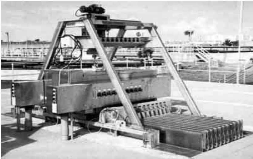
Figura 7-6 – Instalação de desinfecção por UV
