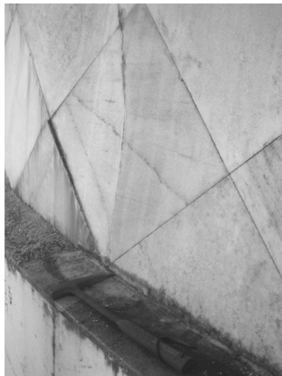
Figura 10 – Fratura de dilatação parcialmente preenchida por cimento carbonático hidratado situada no parapeito dos colares da base da Cúpula.
