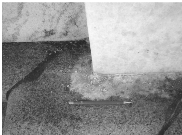
Figura 7 – Precipitação de cimento carbonático hidratado no contato entre a chapa de mármore e os granitos situados na parte superior do domo de sustentação da Cúpula.
