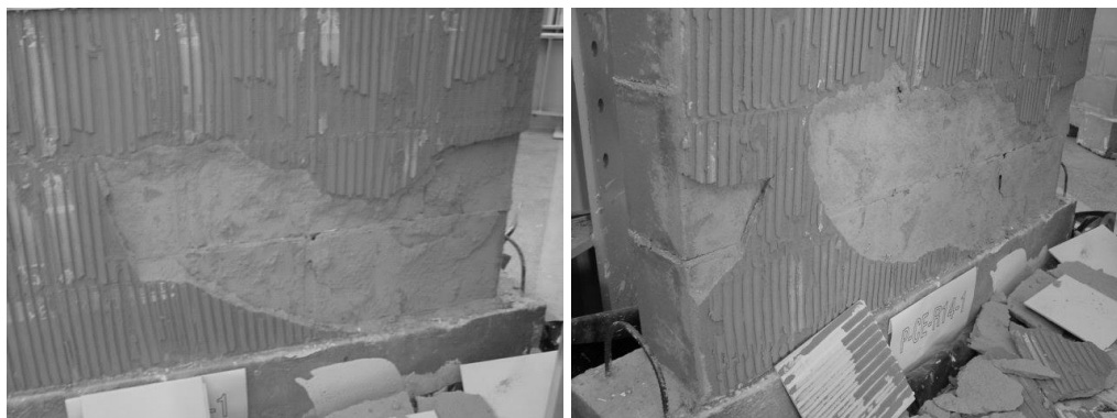
Figura 13 - Paredes cerâmicas com emboço: desprendimento do revestimento e emboço
