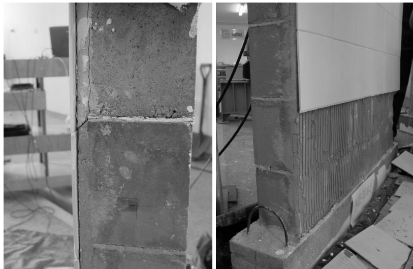
Figura 12 - Paredes cerâmicas com emboço: interface emboço/alvenaria
