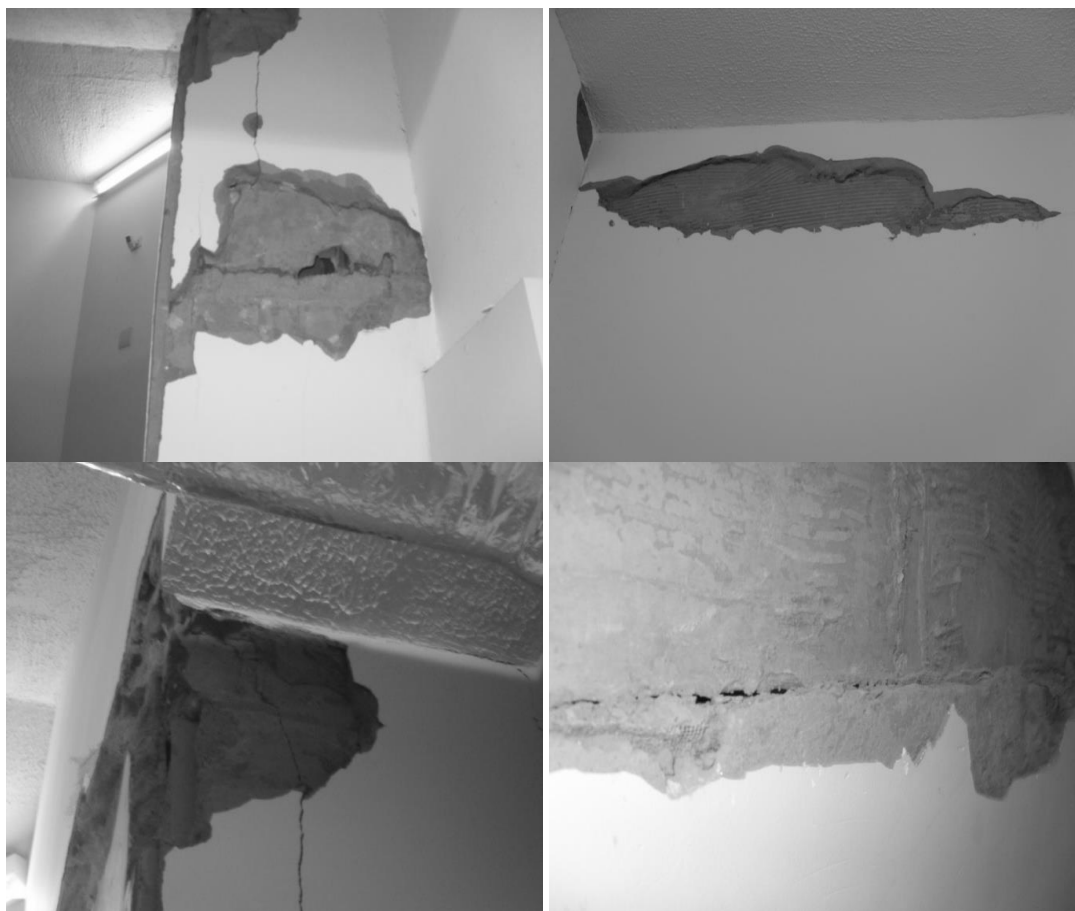
Figura 1 - Regiões mais comuns dos desprendimentos de emboço em ligações de alvenaria estrutural de blocos cerâmico e concreto armado
