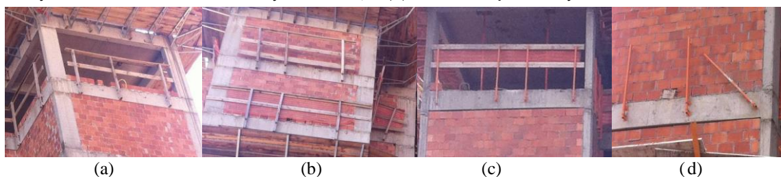
Figura 13 - (a) Remoção do SPP-MA-1 antes da vedação vertical; (b) SPP-MA-1 após vedação vertical; (c) remoção do SPP-MI-5 antes da vedação vertical; e (d) SPP- MI-5 após vedação vertical
