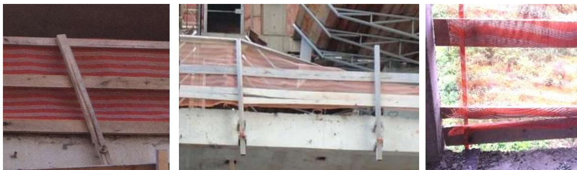
(a) Rachadura no montante e perda da estabilidade
