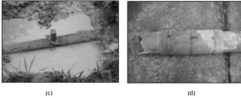
Figura 1 - Problemas diversos de execução e manutenção das tubulações
