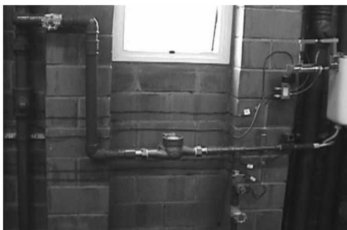
Figura 3 - Detalhe da alimentação da água fria nos protótipos
