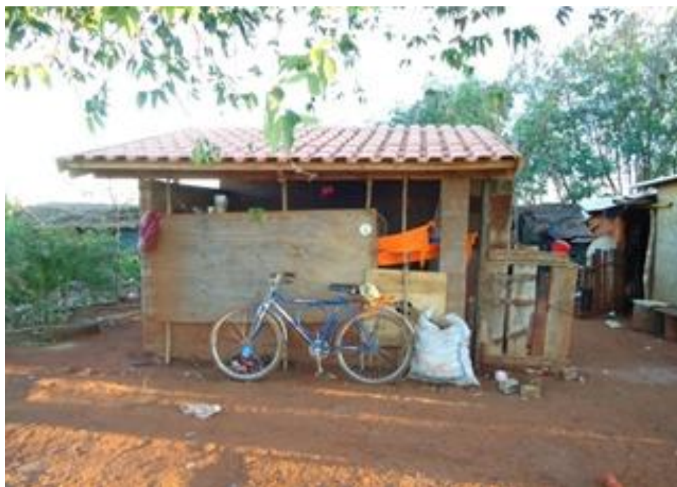
Figura 4. Fogão com estrutura fechada pelos moradores e sem chaminé.
