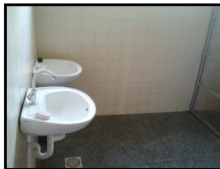
Figura 148: Paredes internas dos sanitários Fonte: Autora
