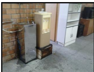
Figura 145: Pisos molhados no Refeitório
