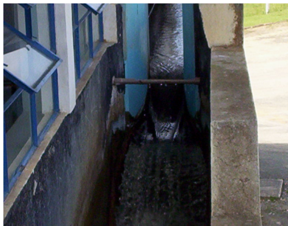
Figura 2: Calha dispersora de sulfato de alumínio na água bruta.
