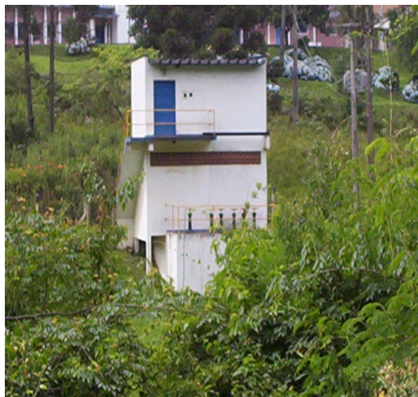
Figura 1: Casa de Bombas, no ponto de captação da ETA sede de Rio Negrinho.
