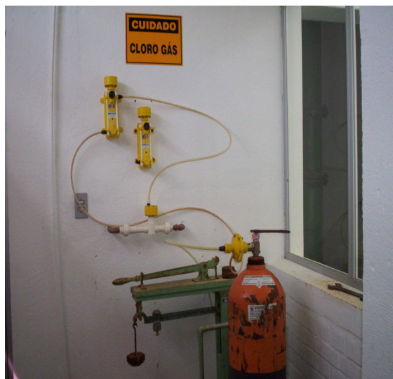
Figura 6: Dosadores de cloro gás.
