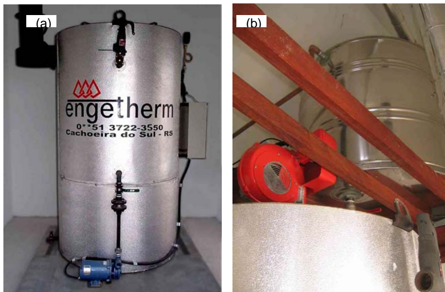
Figura 3.4 Fotografia da caldeira utilizada para o fornecimento de vapor à unidade experimental: (a) caldeira, (b) detalhe do combustor e do tanque de retorno de condensado.
