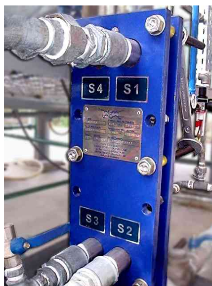
Figura 4.13 Fotografia do trocador de calor utilizado no refeedor da coluna de destilação.
