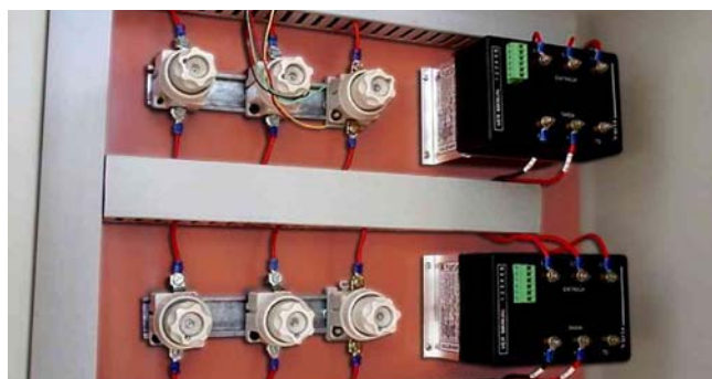
Figura 5.13 Fotografia dos variadores de potência.
