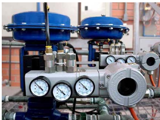
Figura 5.11 Fotografia dos posicionadores das válvulas de controle (Vista frontal).
