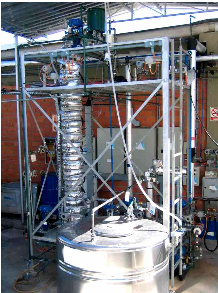
Figura 4.14 Fotografia apresentando a vista geral da unidade de destilação.
