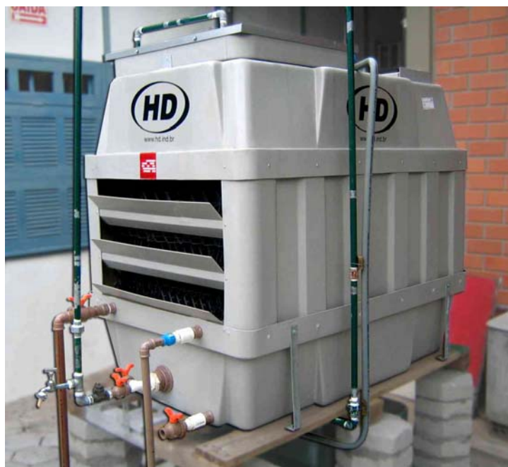
Figura 3.5 Fotografia da torre de refrigeração utilizada no sistema de troca de calor.
