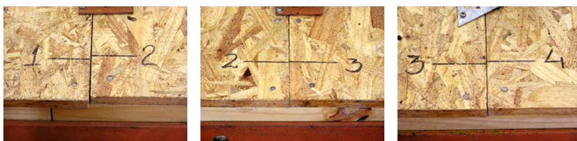
Figura 72 – Pequena separação entre chapas próximo à base, para a parede P488-2J
