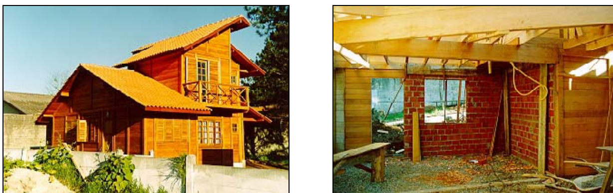
Figura 1 - Sistema construtivo em madeira maciça empilhada. Detalhe de área molhada em alvenaria, por desconhecimento das técnicas.
